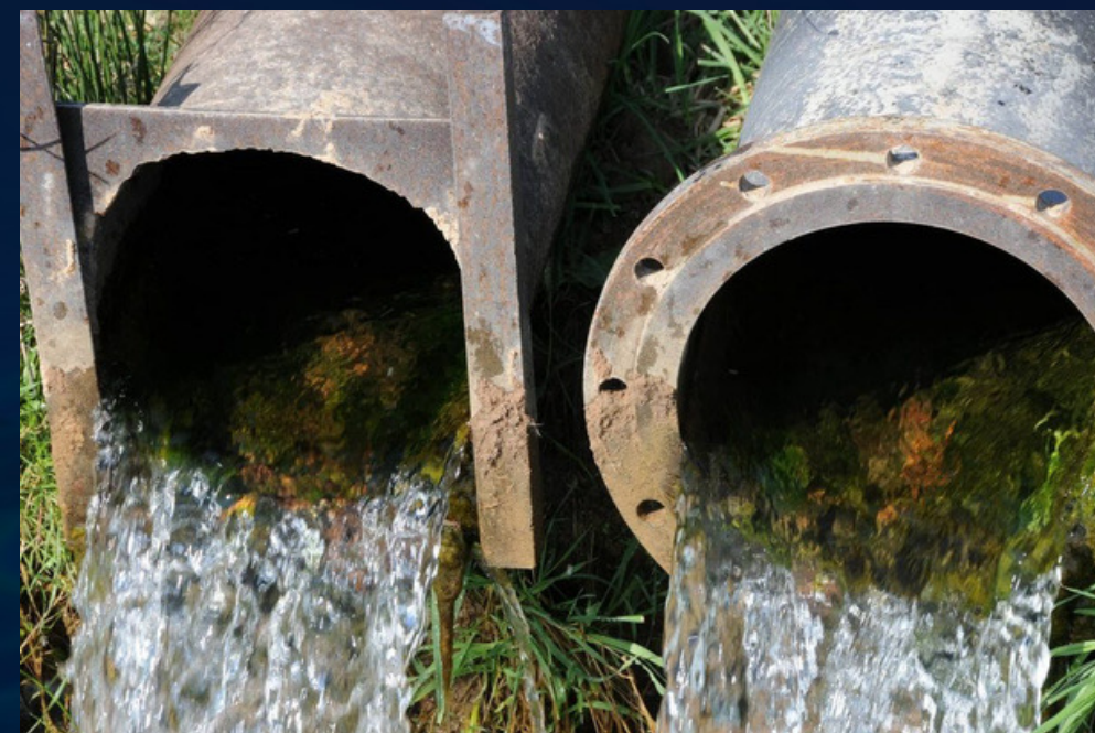
DESCARGAS EN MAL ESTADO
